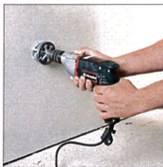
Отворите за конзолни кутии за контакти и електрически ключове се изрязват с фрезер за големи отвори
